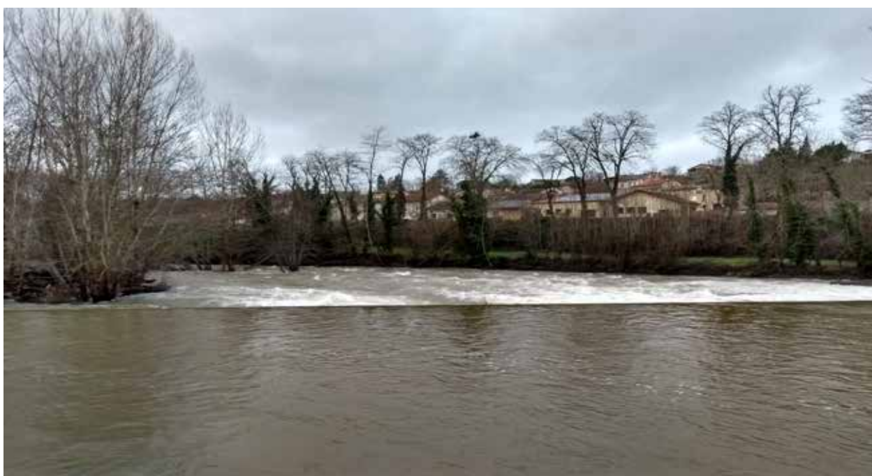
la chaussée en aval du pont, côté Aveyron
